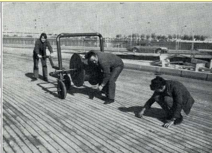
1968 Installazione del nastro scaldante su una rampa di accesso a una piattaforma di parcheggio per autobus, all'aeroporto di Orly, vicino a Parigi (Electric heating of the roadways, by Robert Félix, 1971, Ultimheat Museum*)
